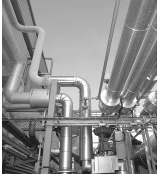
▣ Abb. 2.1 Rohrleitungstransport in einem Chemiewerk. © The Linde Group
