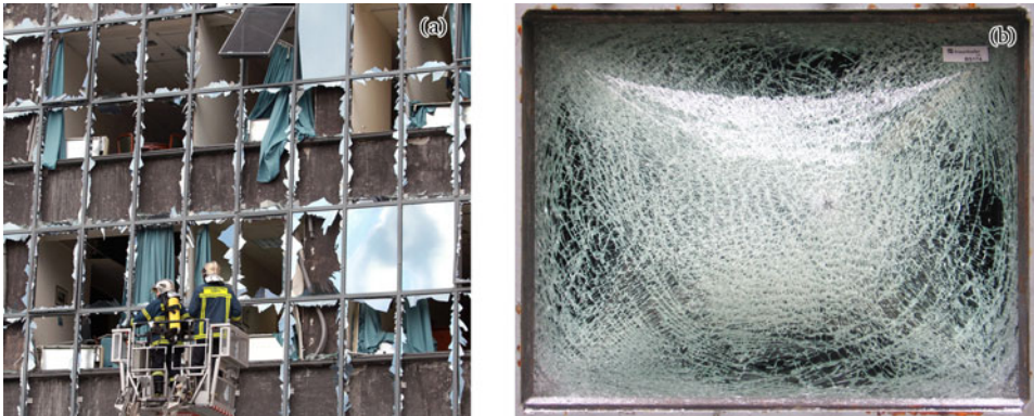
Abbildung 1.2 Auswirkungen einer Explosion auf ein Gerichtsgebäude in Athen mit monolithischem Glas, Bildnachweis: dpa (a); Verbundglas nach einer Prüfung auf Explosionsschutz im Stoßrohr (b)
